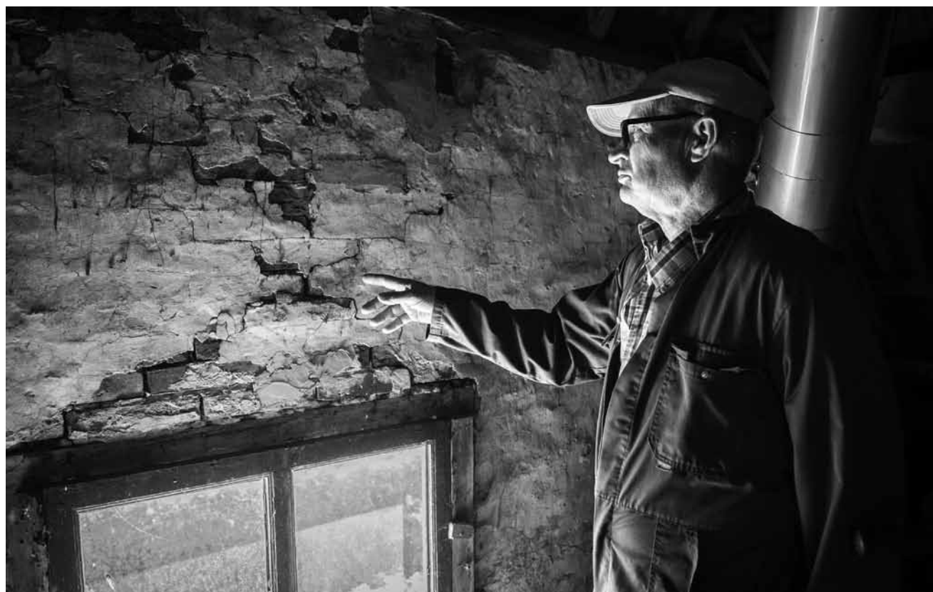
Viele Häuser über dem Groninger Gasfeld haben durch die ständigen Beben Schaden genommen: Ein Einwohner des Örtchens Wirdum weist auf Risse im Mauerwerk seines Bauernhauses hin.
